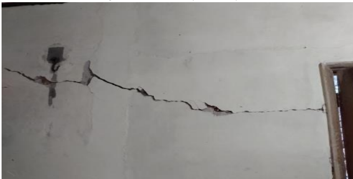
Figura 6. Anomalia 1 na parede do quarto.
